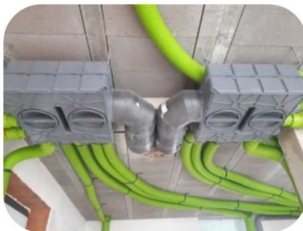
Deux caissons de répartition
