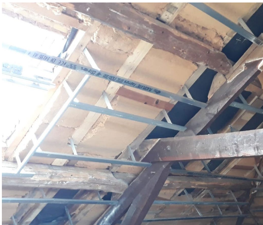
Pannes dans l'épaisseur d'isolation sous chevrons
