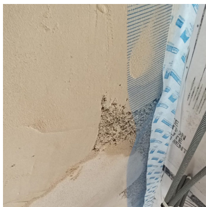
Exemple de raccord Membrane / Enduit terre de finition sur béton de chanvre
