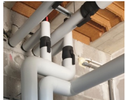
Calorifugeage des vannes
