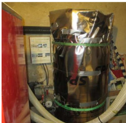
Isolation « maison » à base de panneaux isolant
